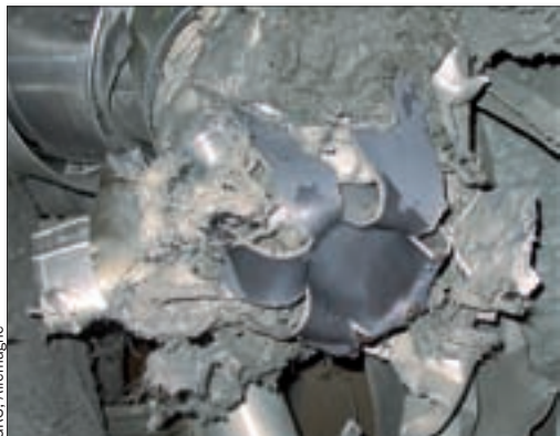
Tuyauterie du REB à la centrale de Brunsbuettel en Allemagne après une explosion d'hydrogène.
