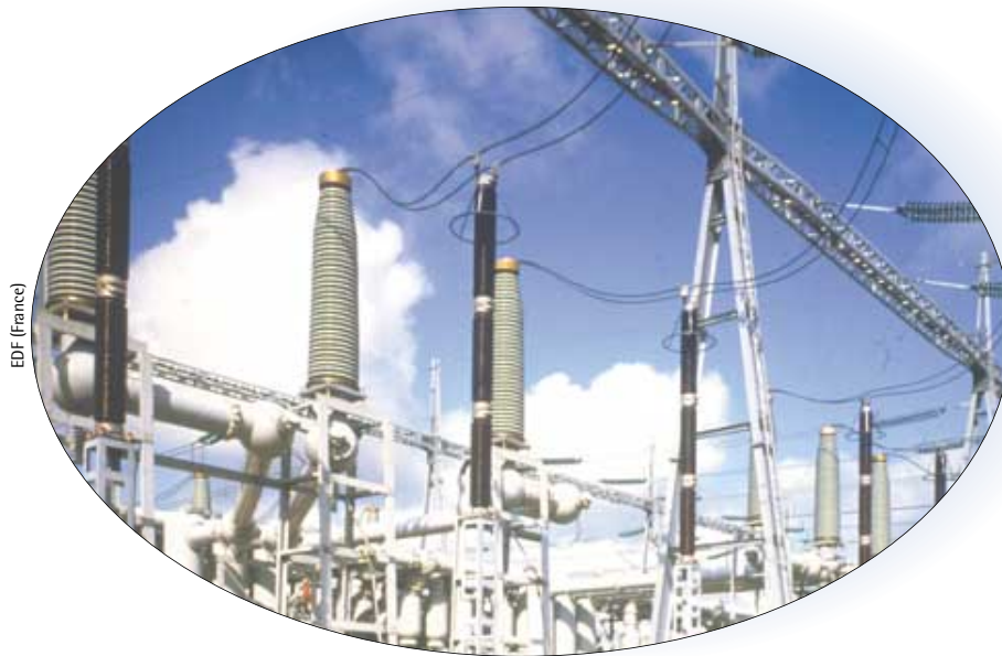
Station de commutation à Chavigny, France.
