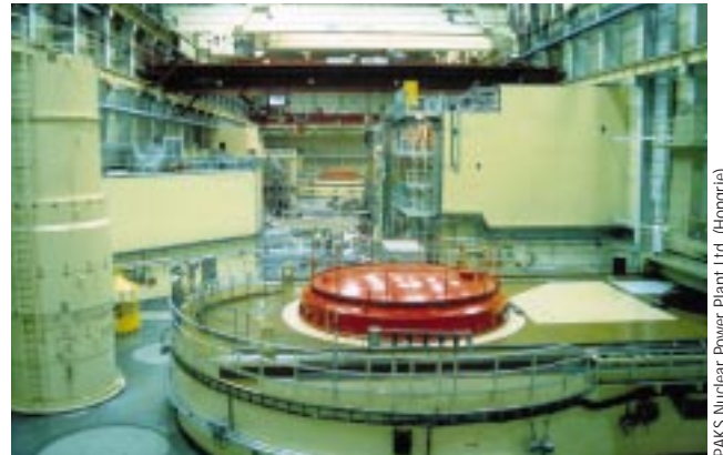
Intérieur de la centrale nucléaire de PAKS, en Hongrie.
