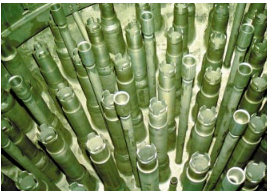
Fond inférieur de la cuve du réacteur de la tranche 1 d'Oskarshamn, en Suède, avec le détail des tubes-guides des barres de commande.
